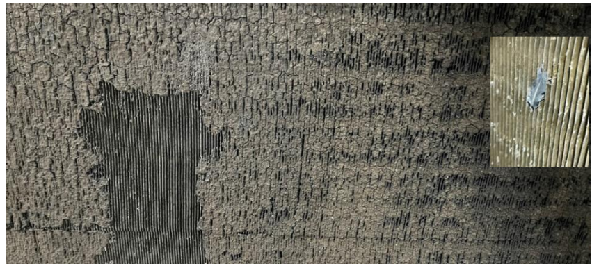
Figura 1: Acumulación de polvo en una batería de refrigeración (arriba a la derecha: pluma de paloma atrapada en una batería de refrigeración).
